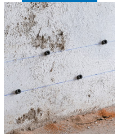
Particolare di iniettori posizionati a quinconce
